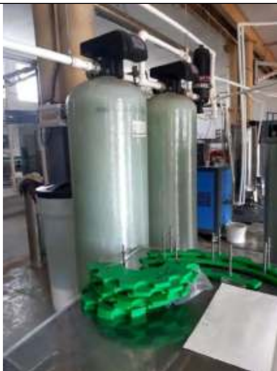
Водоподготовка, инвентарный номер 00-000049
